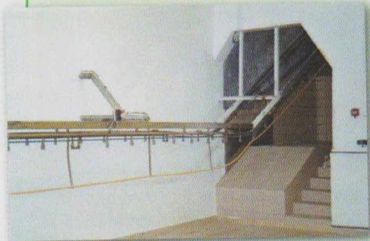
Départ du convoyeur du tunnel
