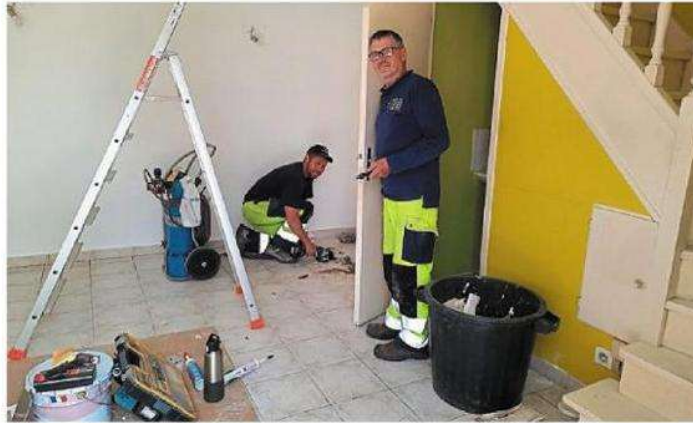
Les employés communaux s'activant dans le nouveau local d'accueil des thermes gallo-romains, au numéro 7 de la rue d'Anjou. | PHOTO : OUEST-FRANCE
