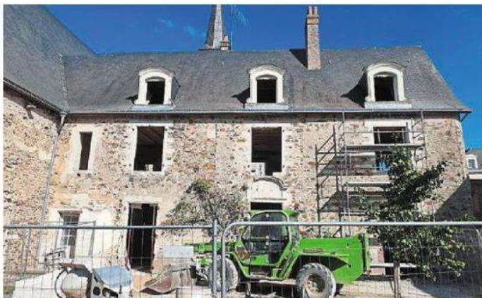
Courants d'air au presbytère causés par les travaux, ici, la façade arrière, côté cour des thermes et médiathèque, des travaux plus lourds que prévu. | PHOTO : OUEST-FRANCE
